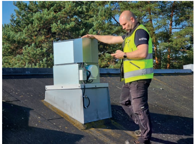
Huippuimurille suoritetaan käyttöönotto etähallinnan avulla. Sensor-ohjausyksikkö sijaitsee laitteen kyljessä turvakytimen vieressä.
